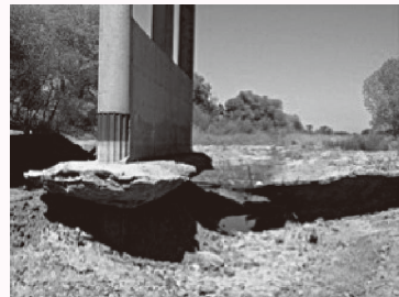
圖 13-55 聖地牙哥附近的一座橋墩在河道中水流強大時所發展出來的挖蝕凹洞。
